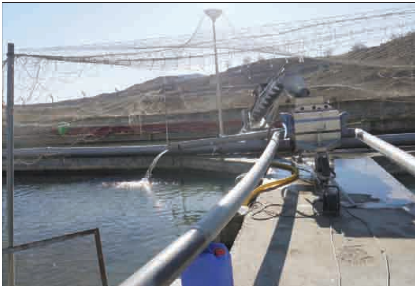
Instalaciones de Naturix en Valderrebollo (Guadalajara).
