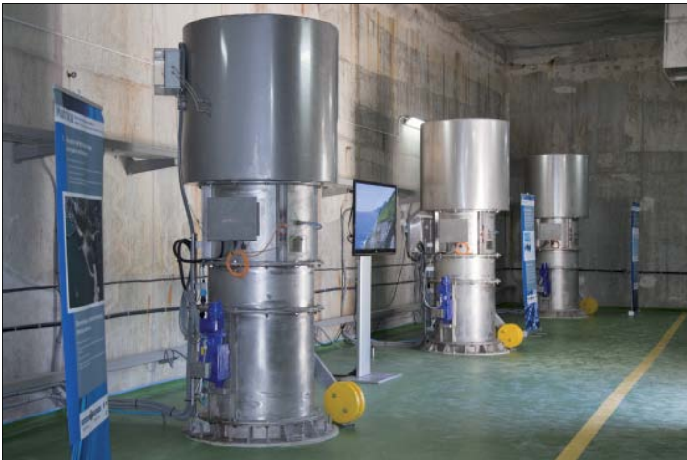
La planta de Mutriku cuenta con 16 cámaras de aire dentro del dique, de forma que, al llegar la ola, presiona el aire de las cámaras y éste asciende pasando por las turbinas, y haciéndolas girar.
