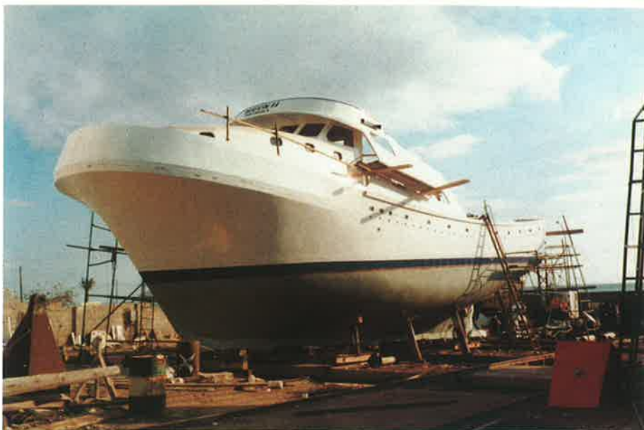
Pesquero en construcción nombrado "MIGON II" de 25 metros de Eslora y 99 T.R.B.. para dedicarlo a la pesca de arrastre.
